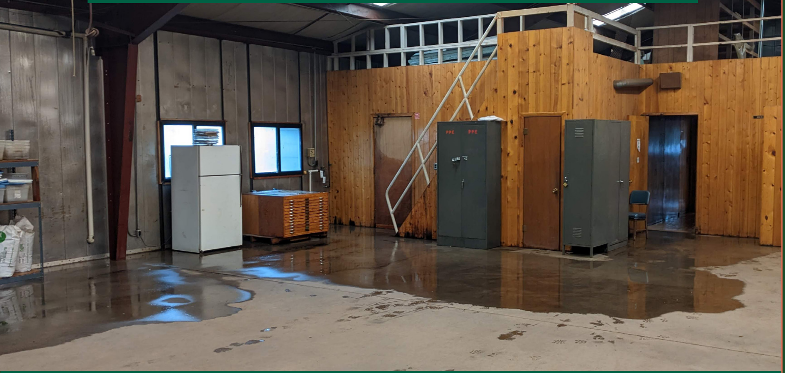
Diciembre 2022: Agua congelada en las líneas de los aspersores de control de incendios ocasionó daños interiores significativos. Izquierda inferior: Estadio Canvas. Derecha inferior y arriba: Oficina principal de Servicios Forestales del Estado de Colorado, Campus Foothills.
